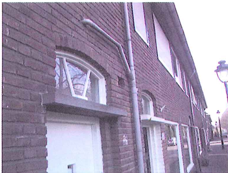
Figuur 2: voorbeeld van een zichtbare foutieve aansluiting (douchewater is aangesloten op regenpijp die afvoert naar een gescheiden stelsel).
